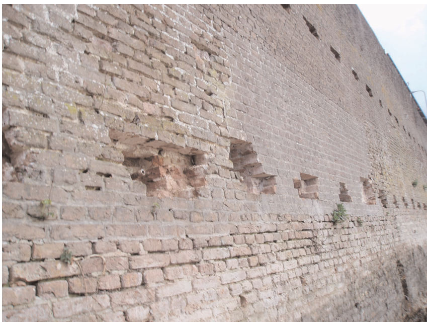
Afb. 18. Put I: de stadsmuur bij F31 en F32 met daarin de gaten die tijdens de restauratie zijn uitgehakt voor het vastzetten van de muurankers, richting NO.
