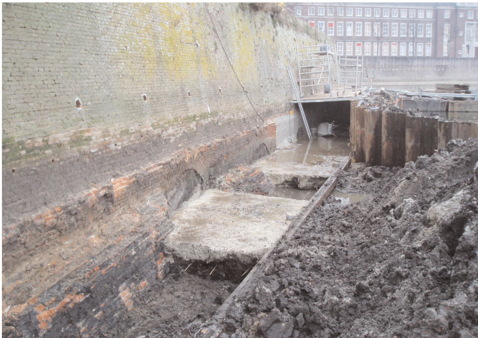
Afb. 3. Put 1: overzicht van de werkzaamheden. De uitgegraven vakken laten P37 en P38 zien, richting NO.
